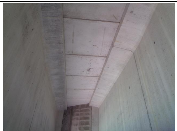
손상현황 • S2 들뜸(0.5m×0.5m) 원 인 • 다짐미흡, 열화 등 조치방안 • 단면보수
