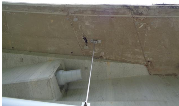
손상현황 • S3 철근노출(0.1m×0.1m) 원 인 • 시공시 다짐미흡, 거푸집 조기탈영 등 조치방안 • 단면보수+방청
